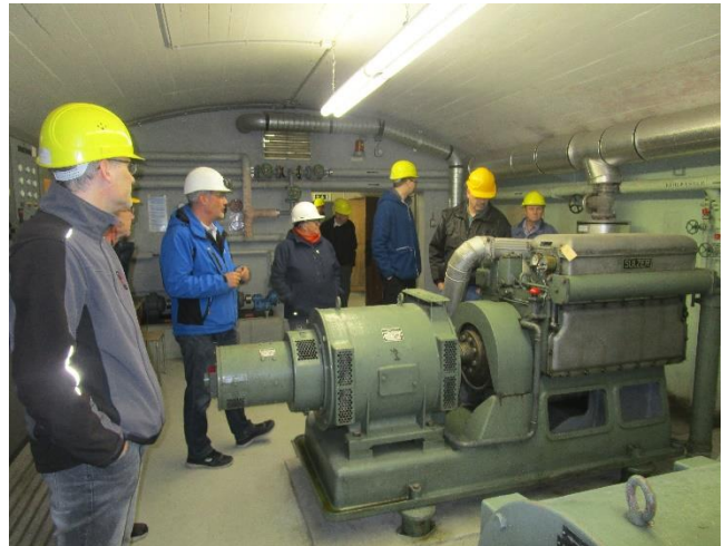
Drei Sulzer Dieselmotoren für die Notstromanlage
